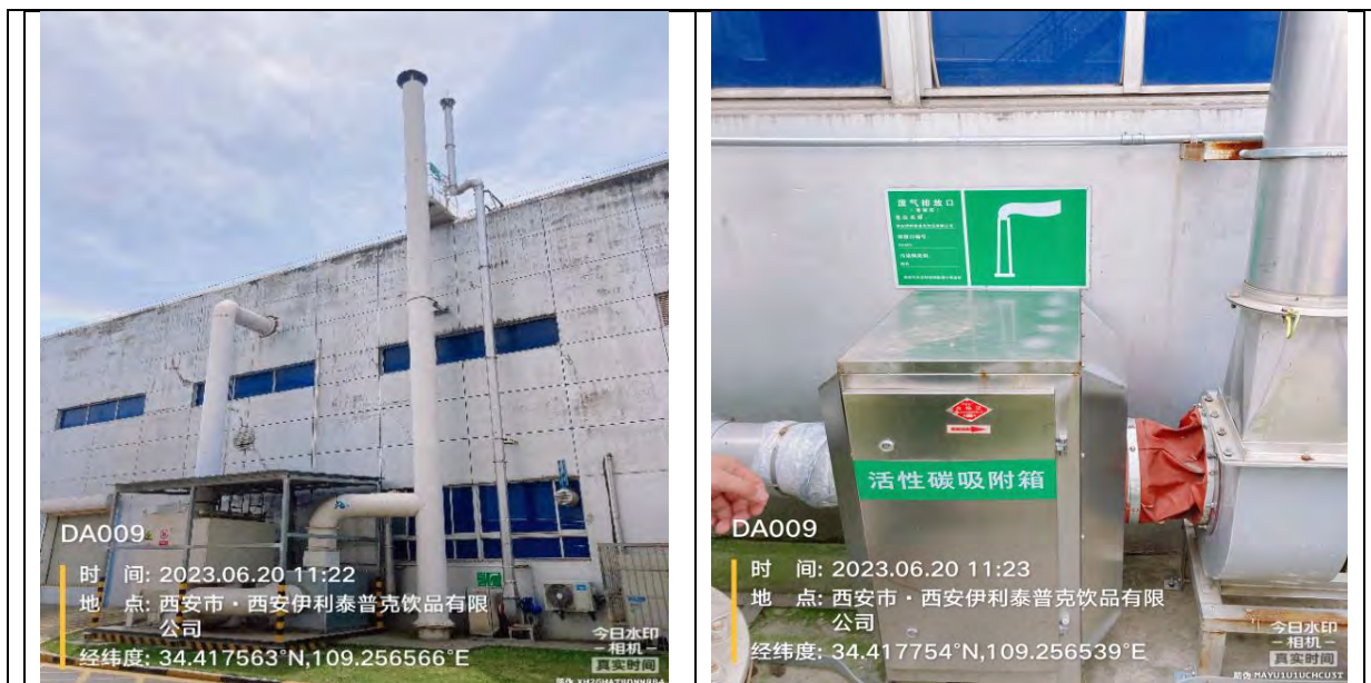
配料化料及香精暂存间废气处理设施及排气筒
