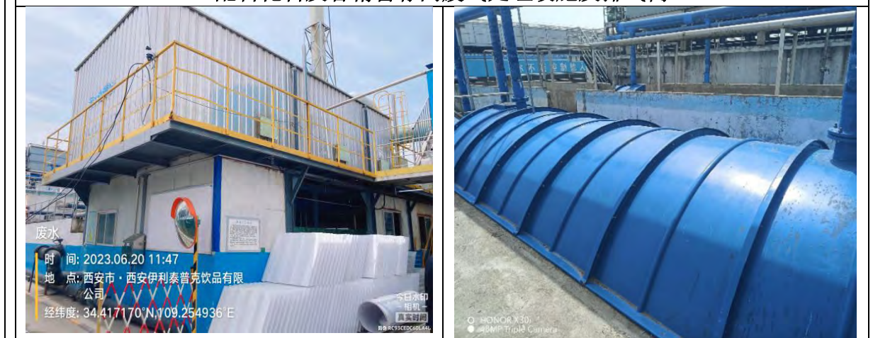
污水处理站除臭设施
